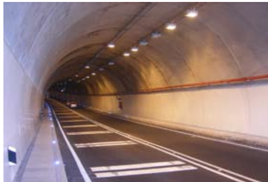
Túnel da Pontinha com uma extensão de 661 metros, situado entre a rotunda da Quinta Magnólia e o nó rodoviário da Av. Sá Carneiro, junto à entrada do Porto do Funchal.
