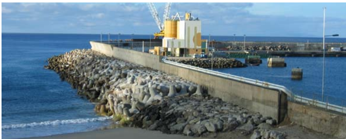
Reperfilamento do segmento-Este do molhe exterior do porto, através da colocação de blocos de betão, retirados do segmento-sul .
